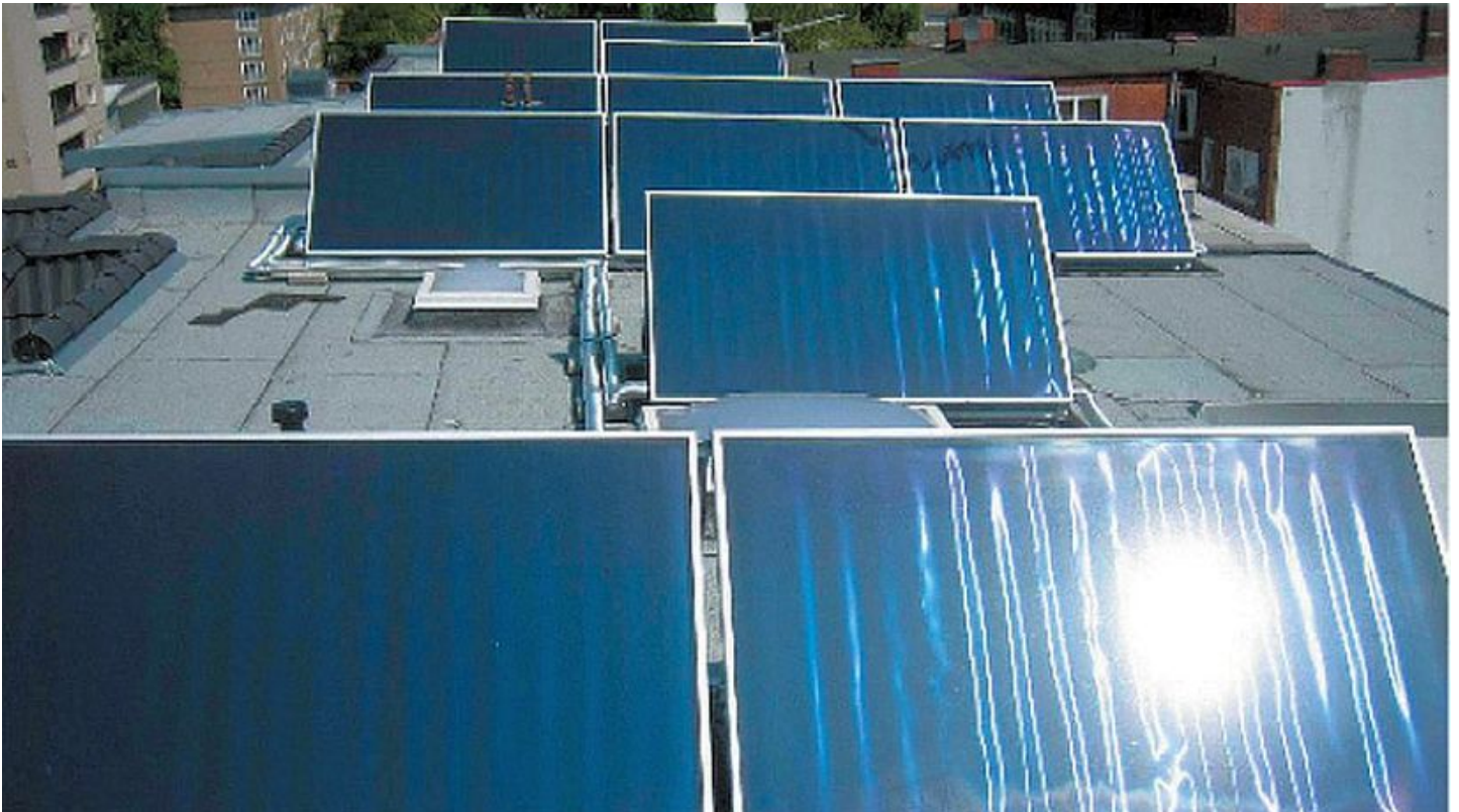
30 m 2 Solarkollektoren auf dem Dach sorgen für Warmwasser
