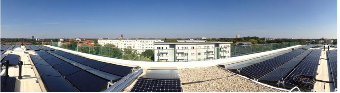
Links: Hybride PVT-Solarkollektoren erzeugen Strom und Wärme zugleich. Rechts: Klassische Photovoltaik-Anlage
